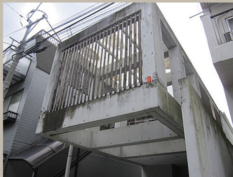
築10年経過のコンクリート打ち放し建造物。 黒カビと汚れによる汚れが顕著。
