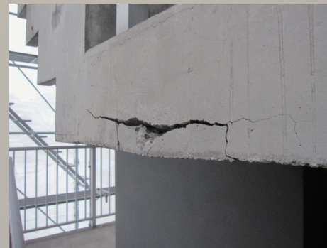
鉄筋が錆びて爆裂している様子。
